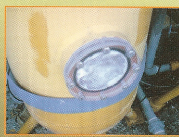
窓がスケールにより閉塞
